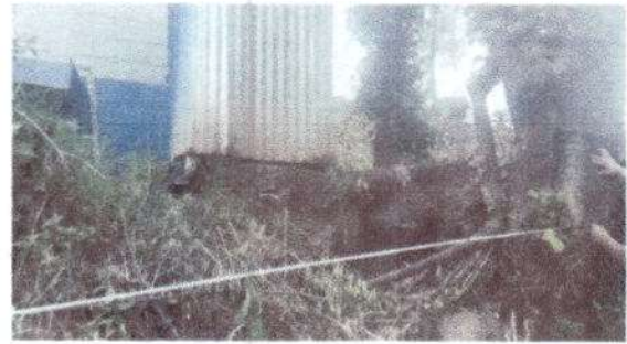
Foto 2: Sanitarios de lamina donde debido a las fuertes lluvias el muro a colapsado.
